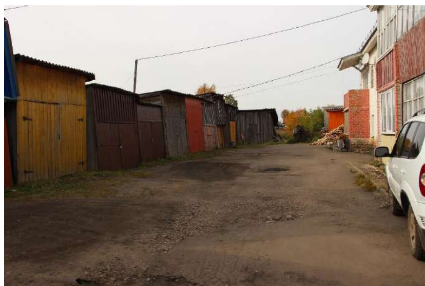
Дефекты асфальтобетонного покрытия проездов
