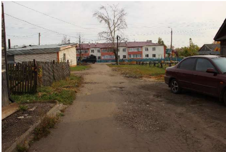
Дефекты асфальтобетонного покрытия проездов
