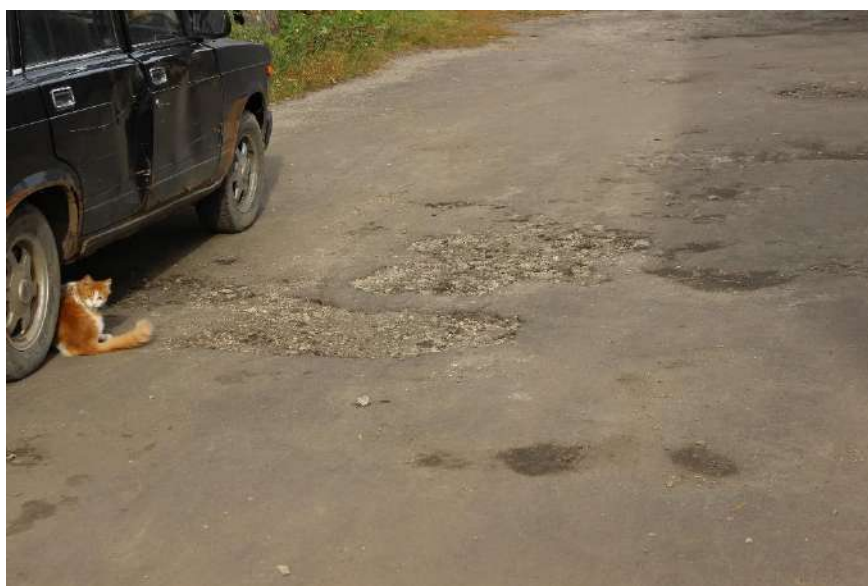
Дефекты асфальтобетонного покрытия проездов
